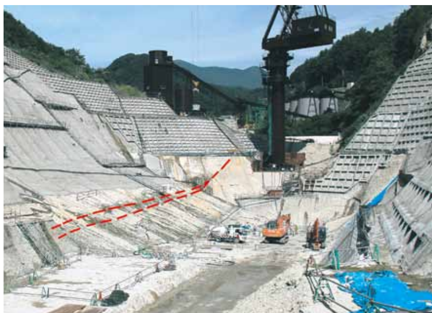
赤線がF-V断層 ダムサイトの直下を走る
